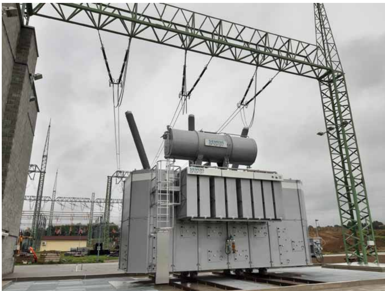
Obr. 3: Tlumivka Mírovka (HBM) TL401 po ukončené montáži
