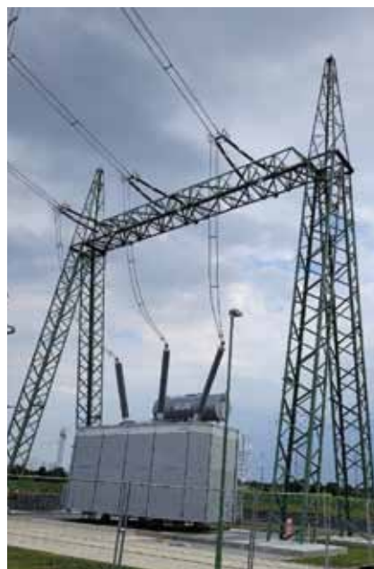
Obr. 6: Tlumivka Čechy Střed TL401 při uvádění zařízení pod napětí
