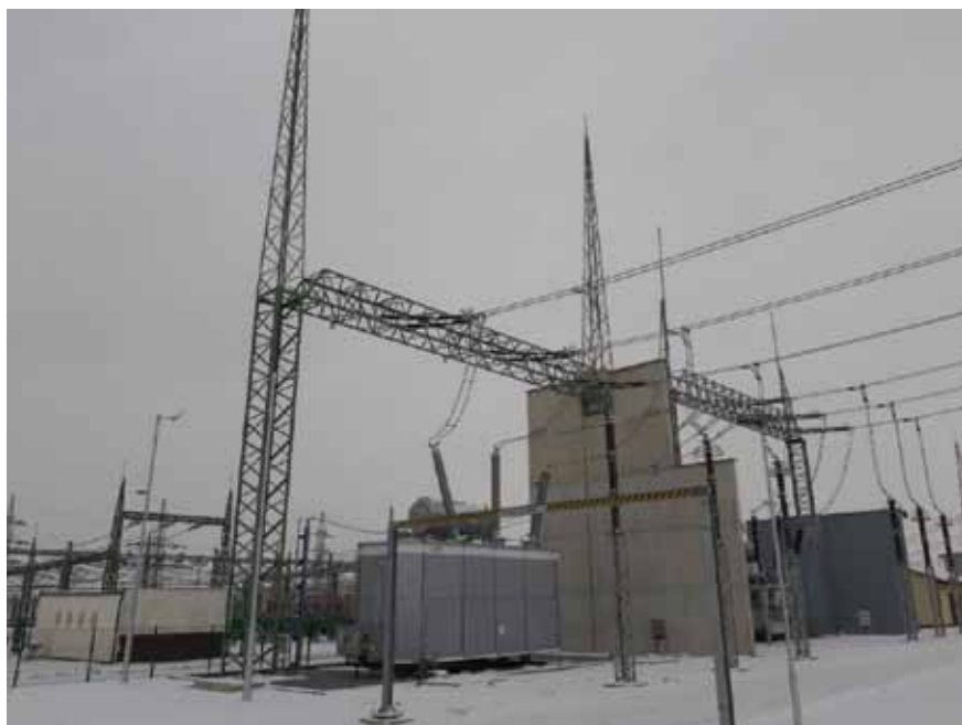
Obr. 4: Tlumivka Krasíkov (KRA) TL401 při uvádění zařízení pod napětí
