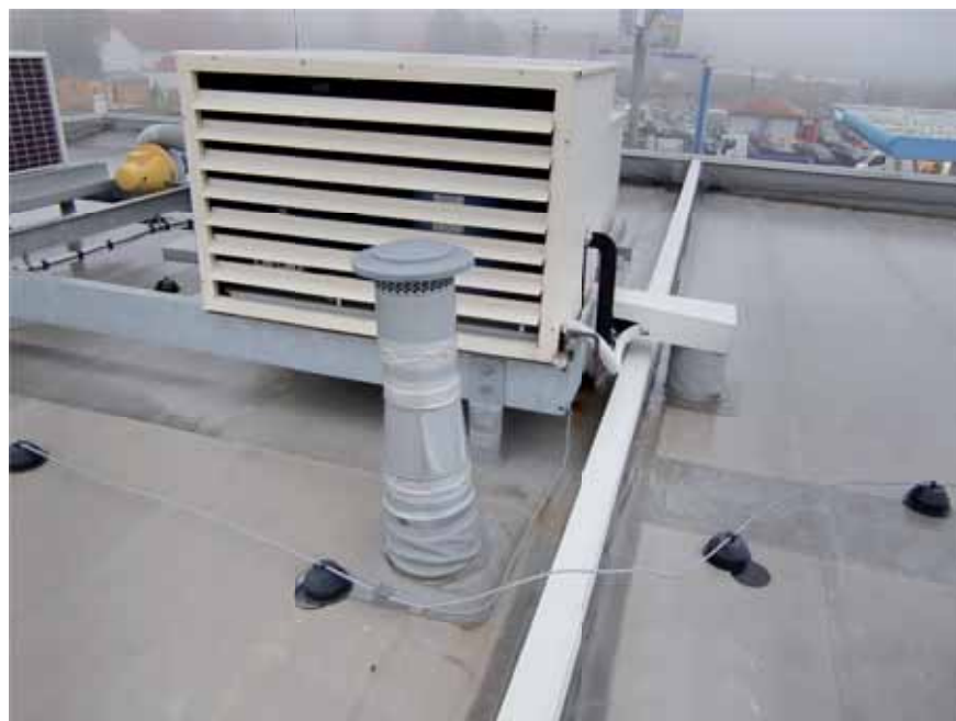
Obr. 5 Klimatizační jednotka, která je spojená s hromosvodem
