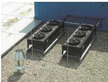
Obr. 2a Umístění výměníku klimatizační jednotky na střeše objektu
