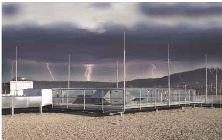
Obr. 4 Instalace systémů DEHNiso Combi pro ochranu klimatizační jednotky
