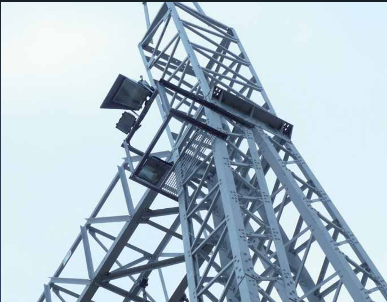
Obr. 4 . Detail svítidel provozního osvětlení R 420kV
