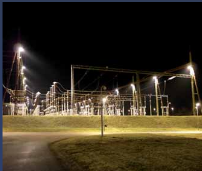
Obr. 2. Provozní osvětlení rozvodny R 420kV
