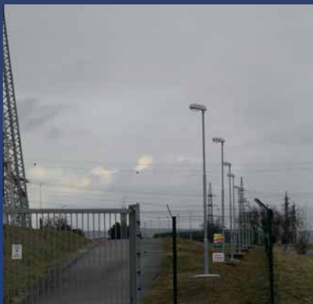
Obr. 1. Hlídací osvětlení podél plotu elektrické stanice
